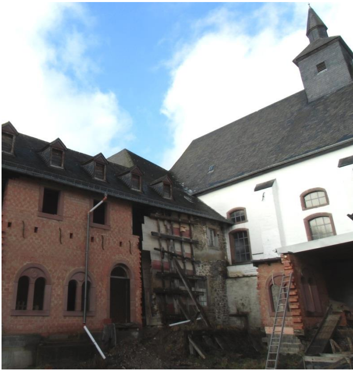
Die gesicherte Mauer zwischen der Klosterkirche und dem neuen, Mauerabschnitt soll abgerissen und neu hochgemauert werden.
